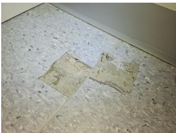
Kuva 17. Alkuperäiskuntoisen osan ja ruokalan välisen henkilökunnan ruokailutilan lattian uudempien pintamateriaalien alla havaittiin mustaa pikiliimaa.
