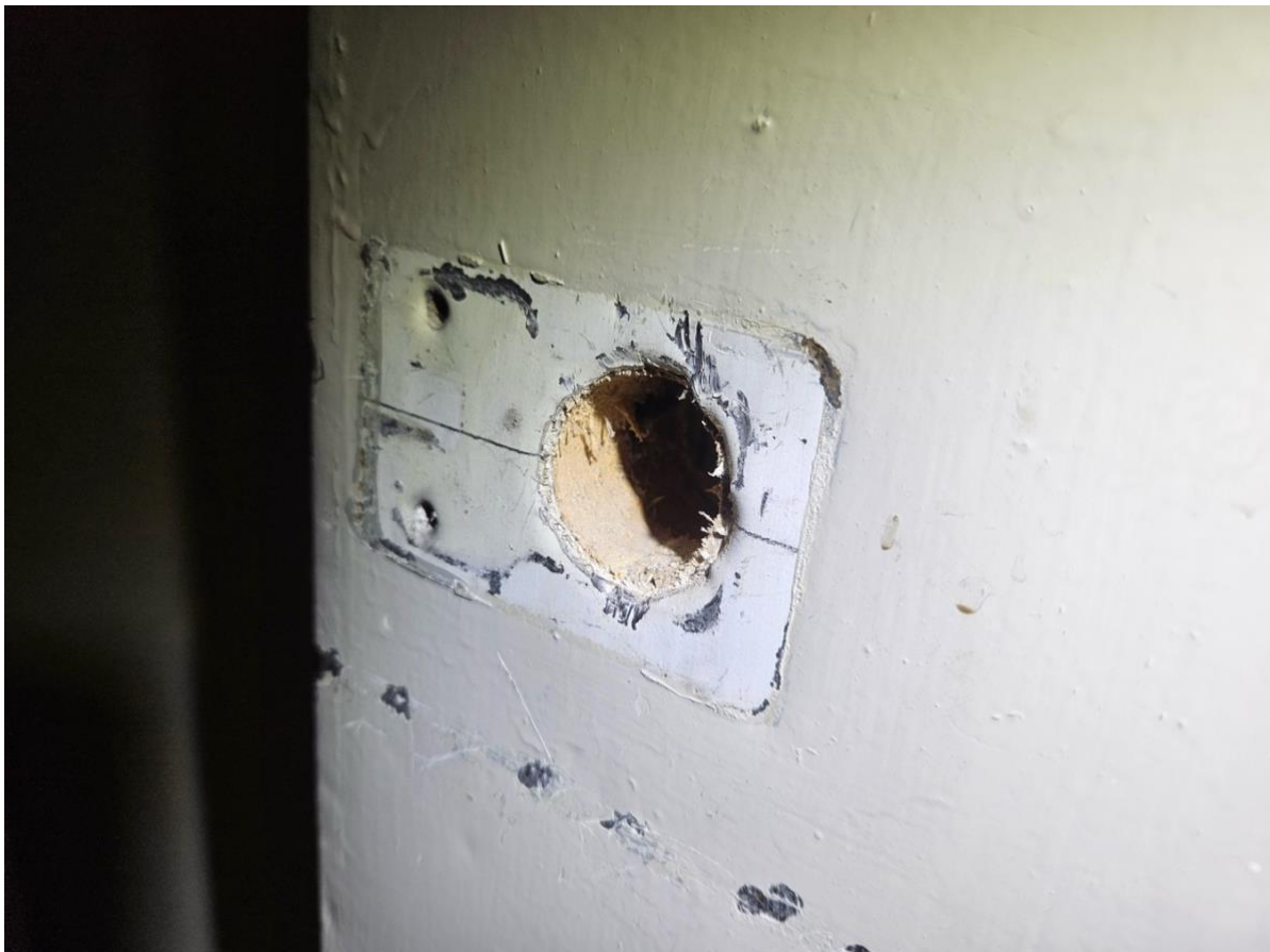
Kuva 27. Palo-oven peltikuoren takana vaalea, tyypillisesti asbestipitoinen eriste.
