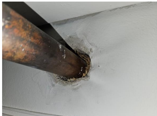
Kuva 8. Seinän läpiviennissä vanhoja asbestieristeitä.
