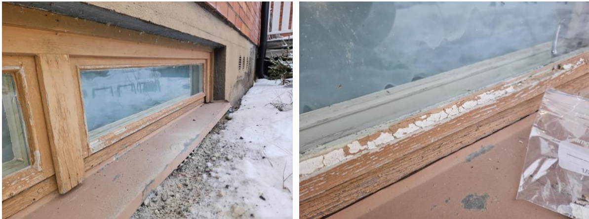
Kuvat 3 ja 4. Kellarin alkuperäisten ikkunoiden lasitusten kitti sisältää asbestia. Rakennusosan muut ikkunat ovat uudempia, eikä niissä havaittu kittauksia. Kitti sisältää myös PCB-yhdisteitä.
