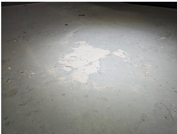
Kuva 24. Maalin alla todettiin asbestia.
