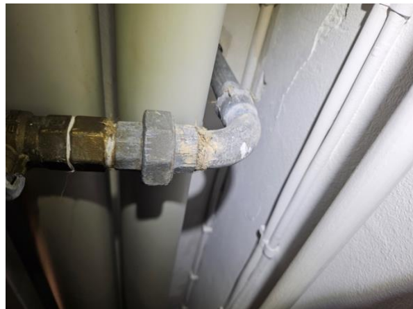
Kuva 6. Kellarin putken eristeet purettu, mutkassa massaeristeiden jäämiä.
