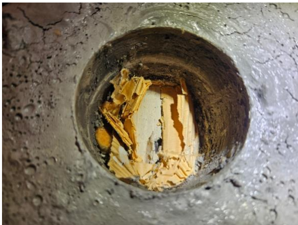
Kuva 5. Välipohjassa kulkeva asbestieristeinen putki.
