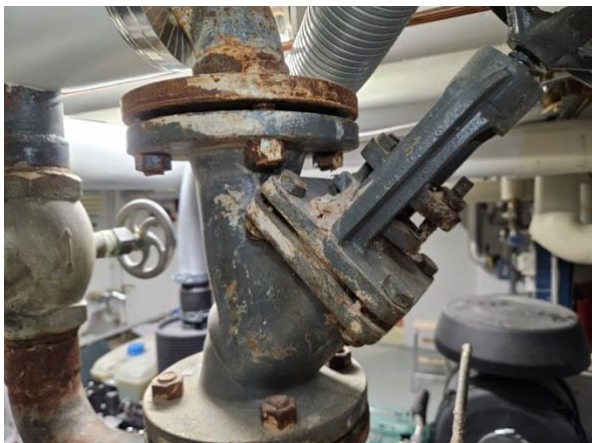
Kuva 7. Venttiilin / sulun pinnalla asbestipitoisen massaeristeiden jäämiä.
