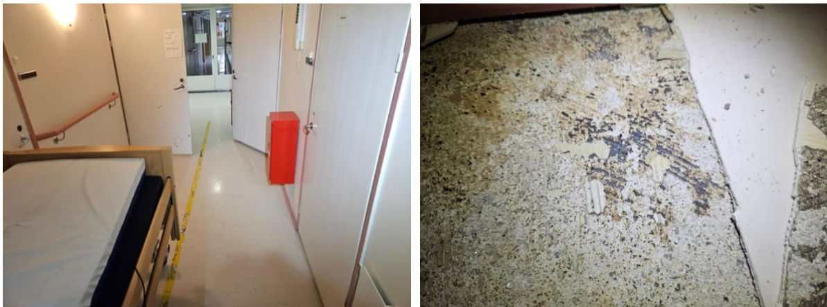
Kuvat 15 ja 16. Alkuperäiskuntoisen osan käytävän lattiassa mustaa pikiliimaa muovimaton alla.
