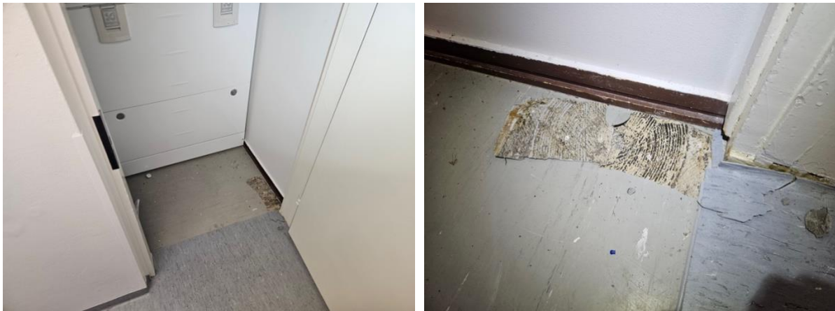
Kuvat 13 ja 14. Peruskorjatun osan 1. kerroksen IV-tilan lattiassa on alkuperäistä muovimattoa, jonka alla mustaa pikiliimaa.
