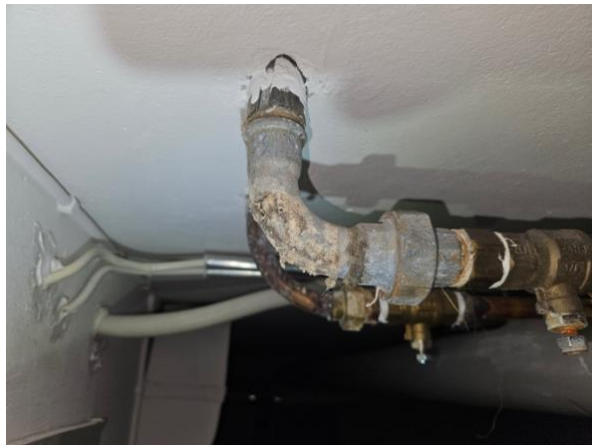
Kuva 10. Kellari, putken mutkassa asbestipitoisen massaeristeen jäämiä.
