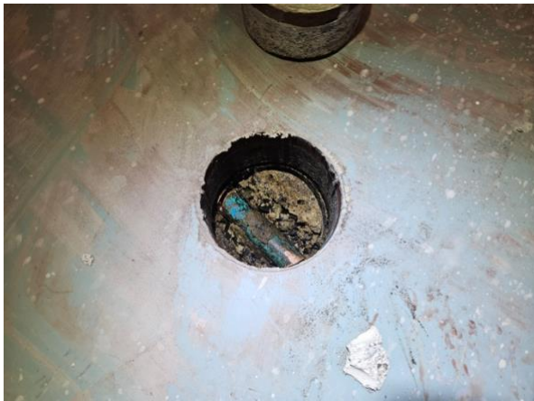
Kuva 9. Näyte ASB 19, naisten pesuhuoneen lattian betonilaatan alapinnalla todettiin asbestikuituja. Avaus osui vanhan putken kohdalle, jonka eristettä oli todennäköisesti tarttunut betonilierion alapintaan.
