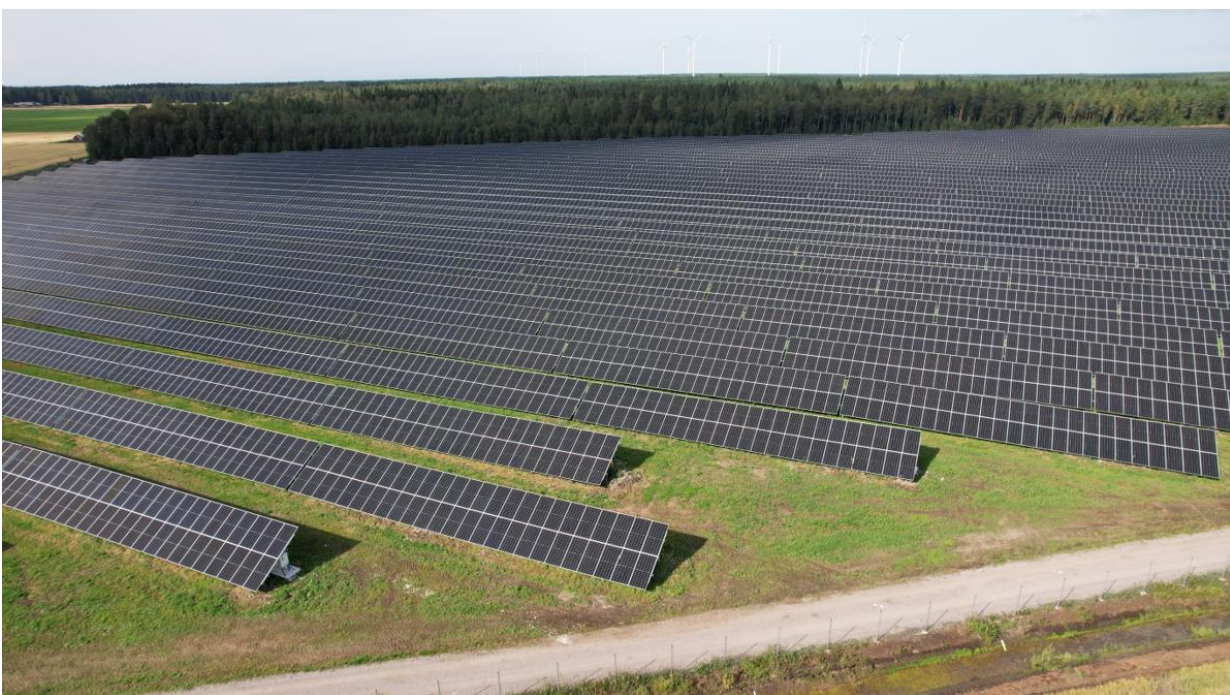
Kuva 3. Paneelirivistöt etelän suuntaan
