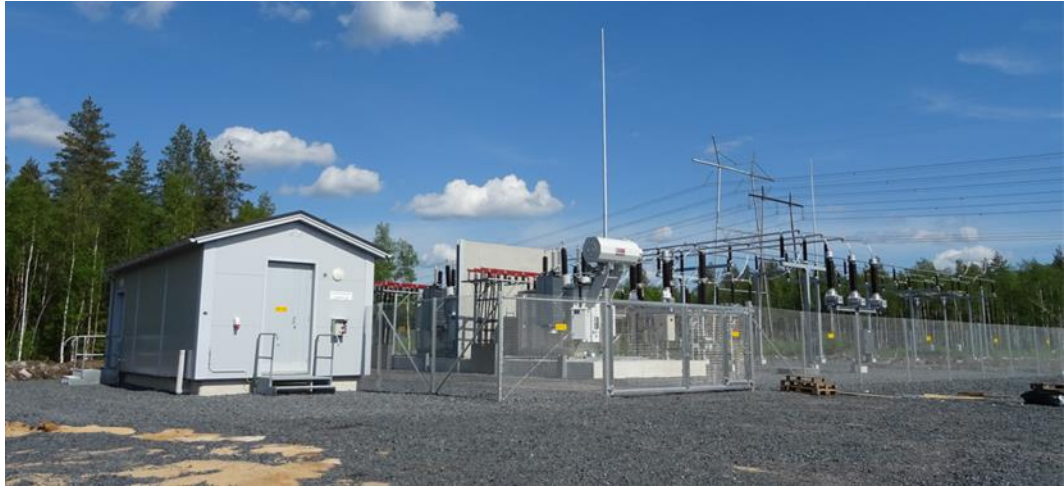
Kuva 14. Esimerkki tuulivoimapuiston sähköasemasta (Oltava, Pyhäjoki).
