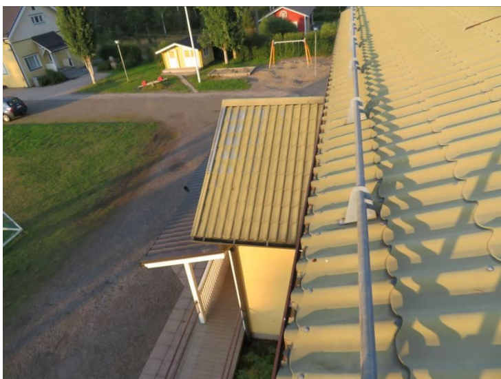
Kuva 28: Peltikatteen maali hilseilee ulko-oven katoksen päältä.
