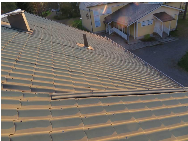
Kuva 35: Pihan puolelle on syytä harkita toista lumiestettä vanhan lisäksi.
