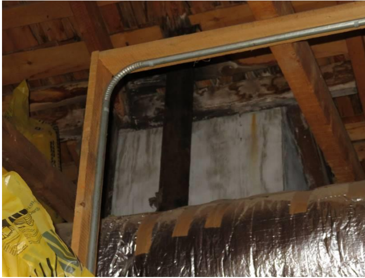
Kuva 26: Suuria kosteusvaurioita hormin läpiviennin kohdalla.
