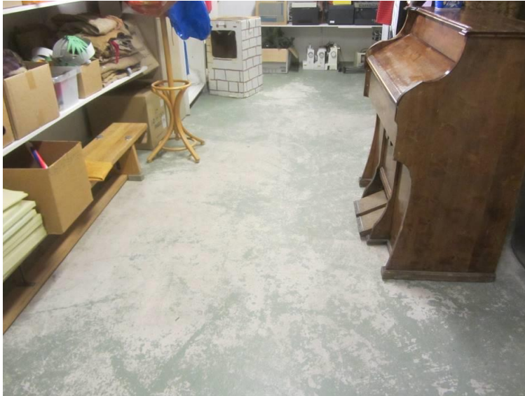
Kuva 22: Kellarin lattiamaalit ovat suurelta osin hilseilleet irti alustastaan.
