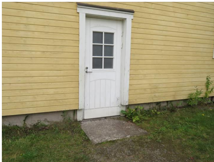
Kuva 19: Ulkoiluvälinevaraston ovi on maan tasalla ja oven edessä oleva kivi voi edesauttaa kosteuden pääsyä sisätiloihin. Oven päällä ei ole lippaa.
