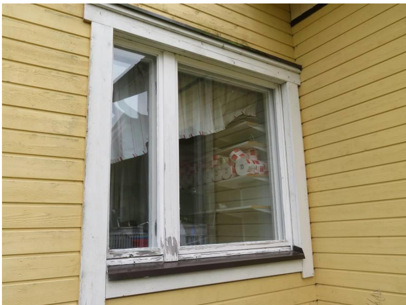
Kuva 16: Etupihan puolen vanhojen ikkunoiden puuosien maalit ovat hilseilleet
