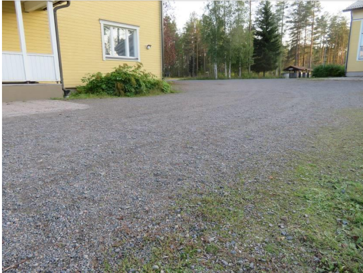
Kuva 36: Piha-alueen kaadot eivät ole riittävät.
