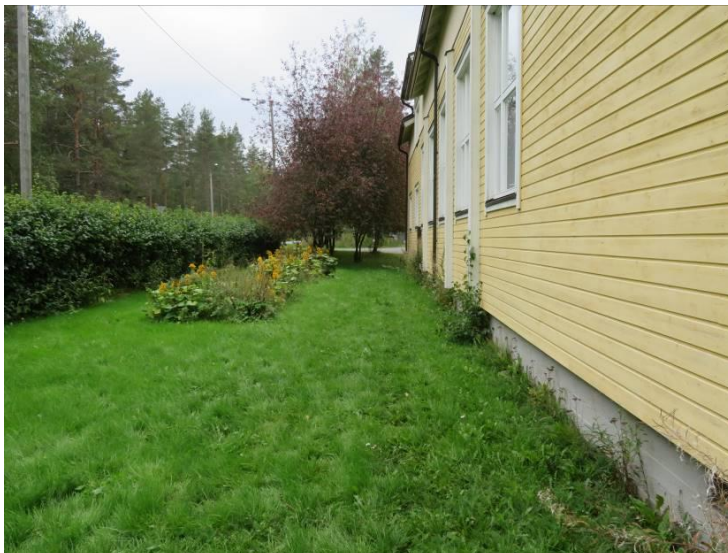
Kuva 37: Takapihan maa näyttäisi kaatavan rakennusta kohti.
