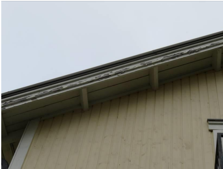
Kuva 29: Otsalautojen maalit hilseilevät.
