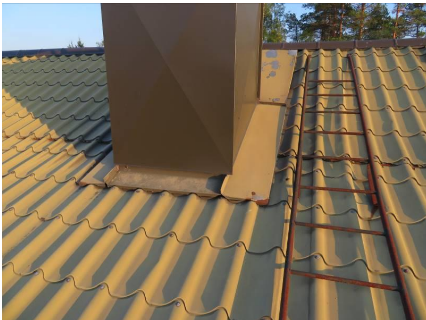
Kuva 32: Tikkaat katon harjalle ovat ruostuneet.
