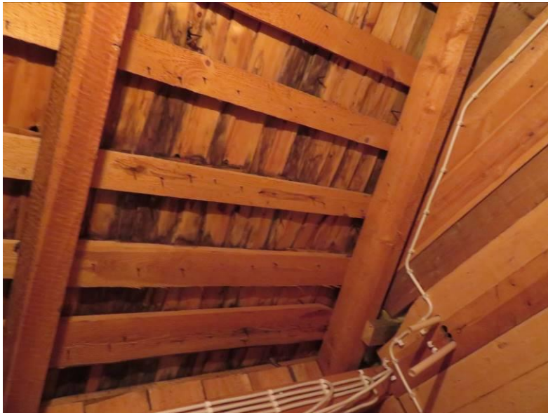
Kuva 25: Pärekatossa kosteuden aiheuttamia jälkiä.
