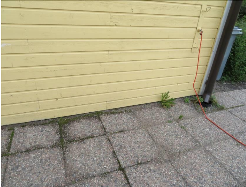
Kuva 30: Etupihan puoleista betonilaattaa. Julkisivulaudoitus on käytännössä maata vasten.
