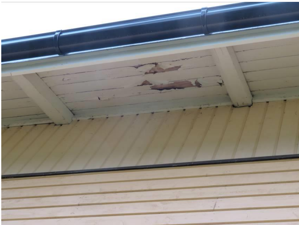
Kuva 23: Räystääslaudoituksen maalit hilseilevät paikoin
