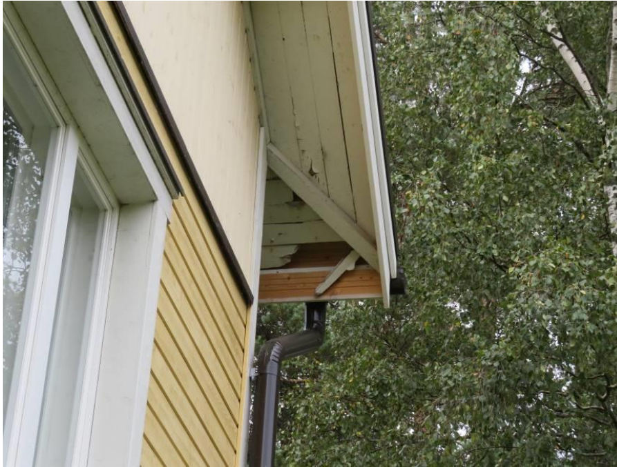
Kuva 24: Vaurioitunut räystäälauta ja maalin hilseilyä
