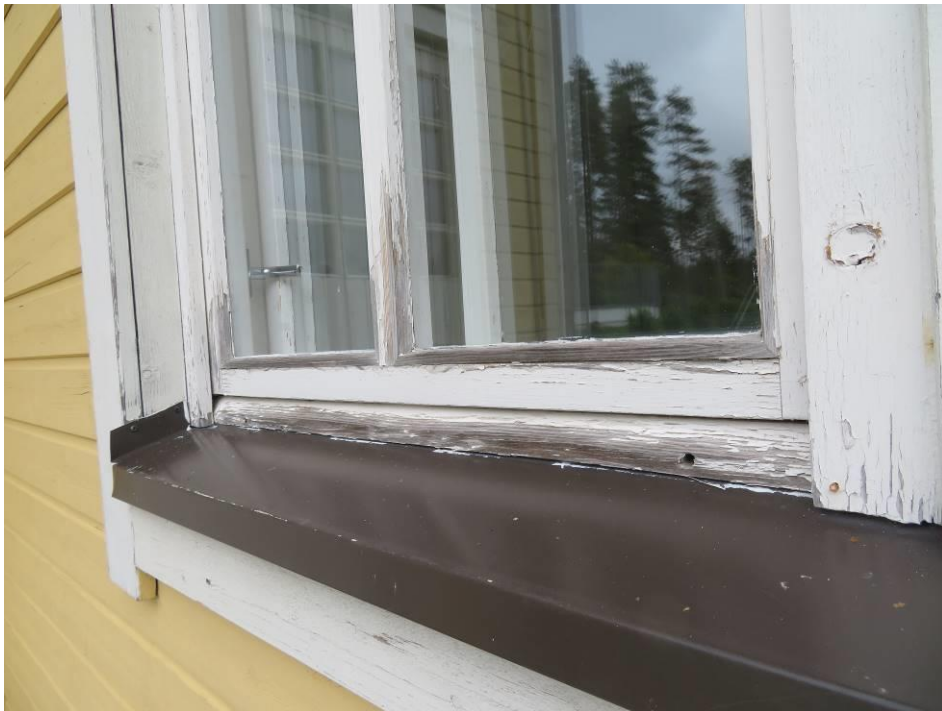
Kuva 12: Vanhojen ikkunoiden puuosien maali hilseilee. Pellitysten kallistukset ovat riittävät.
