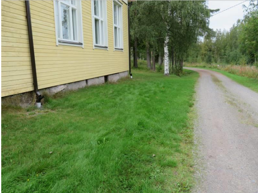
Kuva 28: Piha-alueen kallistukset ovat välttävät, ja syöksytorvien alueella onkin havaittavissa pientä painumaa.
