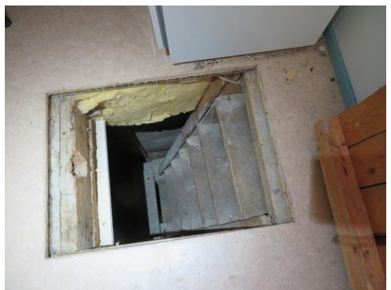
Kuva 8: Epätiivis kellarin luukku
