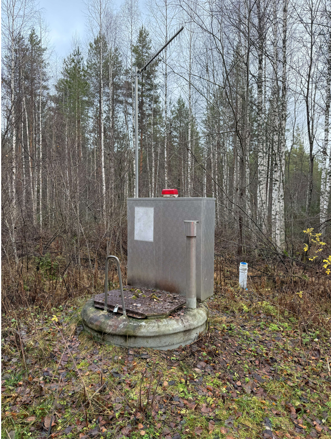
Kuva 7. Lestijärvi-Kinnula siirtoviemärin lähtöpumppaamo.
