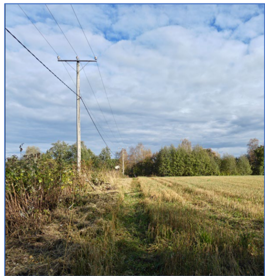
Kuva 9. Alueen pohjoisrajalla kulkeva jakelujännitelinjä lännestä päin kuvattuna. © Plandea Oy
